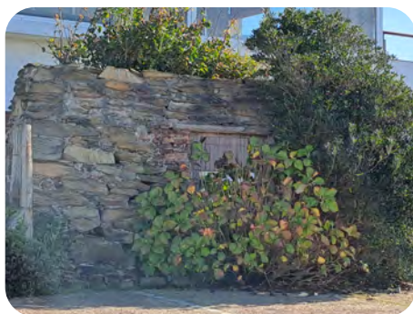
Figura 8. Restos del revestimiento de una construcción antigua en la rambla de La Pedrera.
